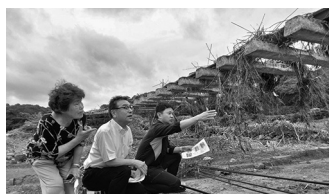
線路が浮いた現地を視察（美祢市） （7月14日）
